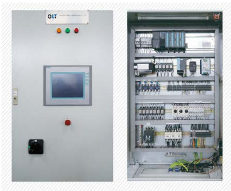
Рис № 37 Локальная панель управления турбокомпрессором
