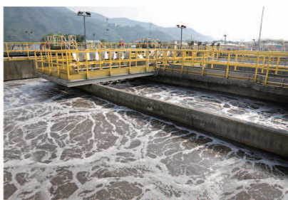
Очистка сточных вод
